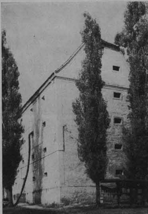
Fot. 17. Czasem dekoracje zredukowano do minimum: niezwykle rozmiarami, cztero-kondygnacyjny spichlerz w Lisach (pow. prudnicki) wzniesiony w 1755 r., a rozbudowany czy przebudowany w 1832 r. jest zdumiewającym jak na czas swego powstania przykładem „punktowca”, w którym funkcjonalnym formom przydano najprostszą dekorację z obramień i płycin wykonanych w zaprawie.
