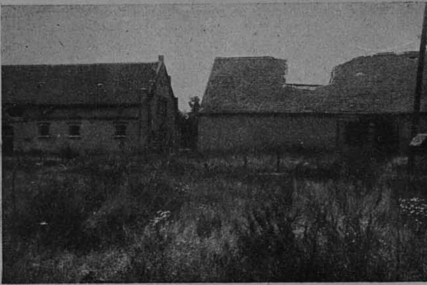
W wyniku działań wojennych tutejsze wsie i majątki zostały w większości b. silnie zniszczone. Odbudowa czyni jednakże szybkie postępy. (Przed odbudową)
